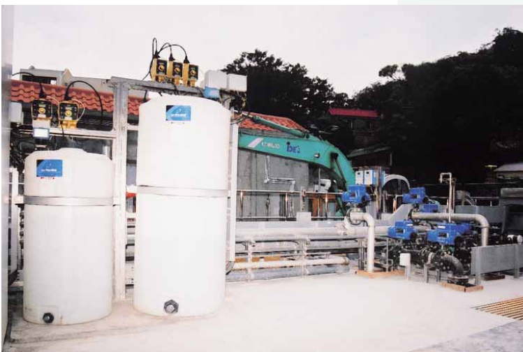
喜靈洲島上的污水處理設施。 Sewage treatment facilities on Hei Ling Chau
